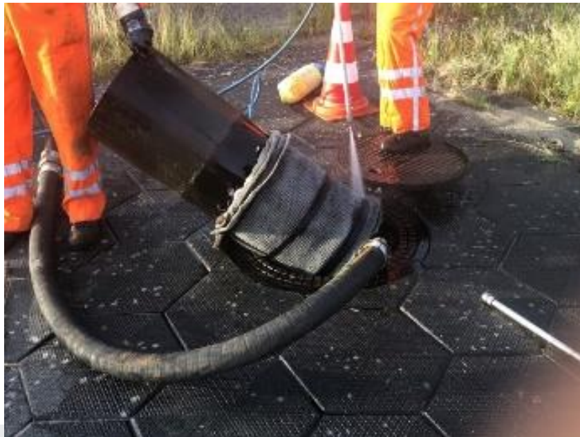
Foto: Controle ingebouwde onderdelen afscheidingsinstallatie
